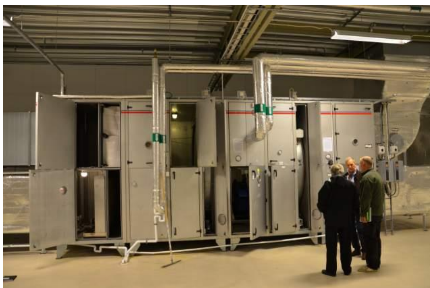
Energi- og miljøavdelingen på befaring på Erikslund kjøpcenter i Sverige for å studere sorptiv kjøling i praksis.
